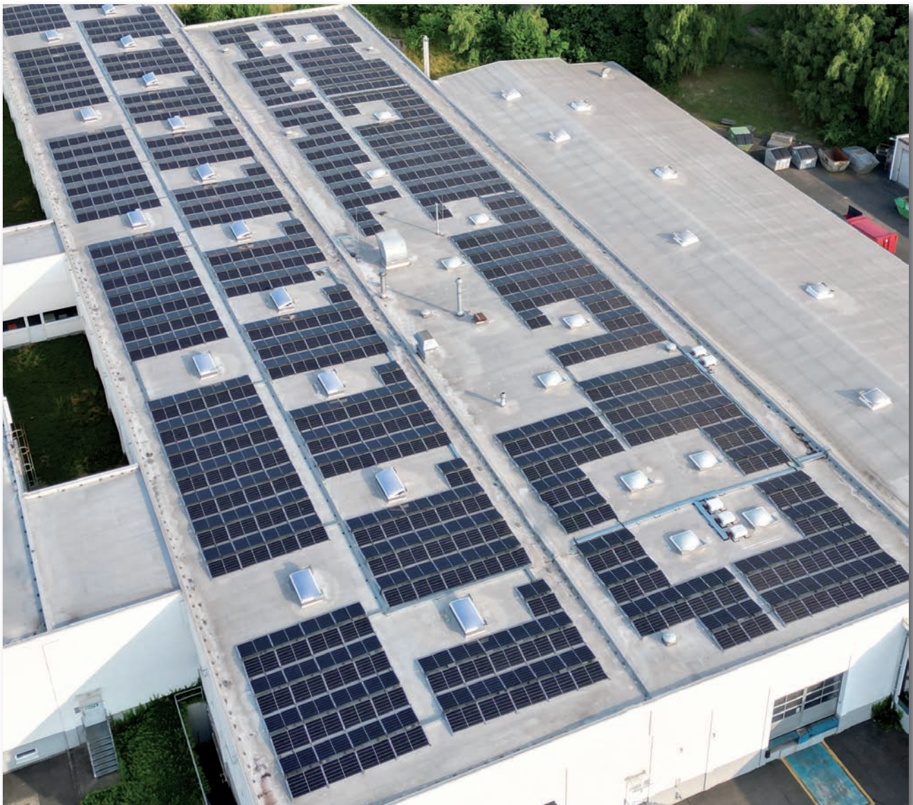
Bild 1: Photovoltaikanlage auf den Werkshallen von BOY
